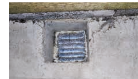
Tiltak for at rotter ikke skal komme inn gjennom lufteventil i kjeller.
