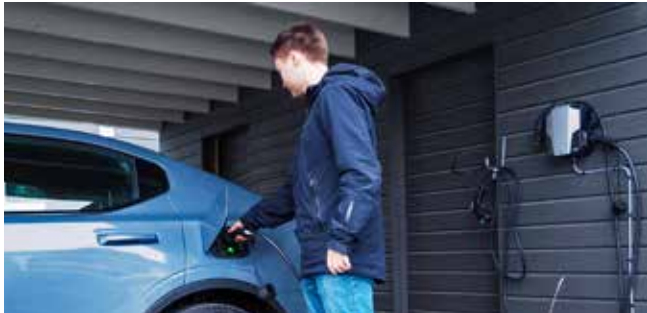
Fra 1. juli 2022 har elbileiere som skal etablere lading hjemme måttet installere ladeboks. Lading fra vanlig stikkontakt er ikke lov der du lader i det daglige. (Foto: NAF).
