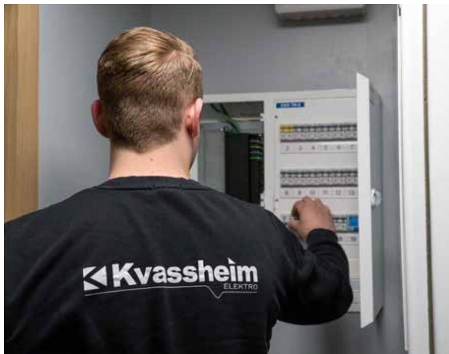
En elkontroll er anbefalt gjennomført hver 5. til 10. år.
